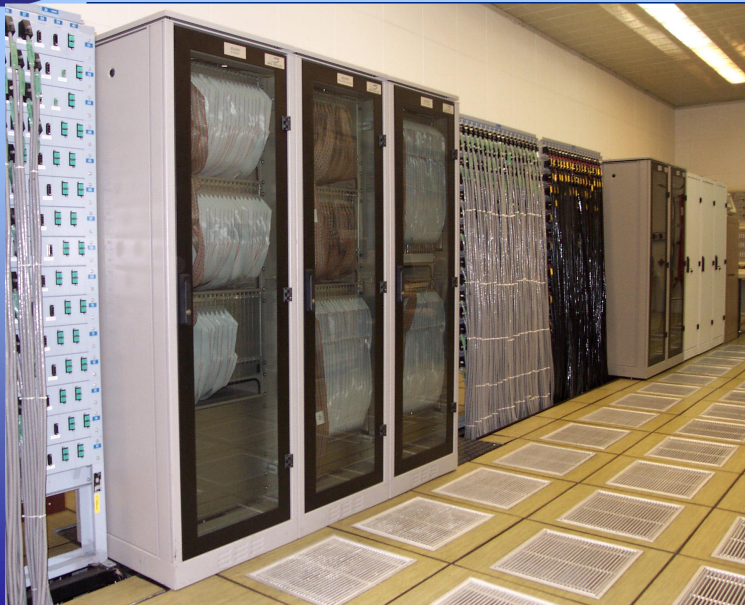
A szimulátor vezénylő kábelezése
